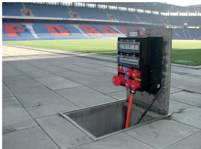
Unterflurelektrant, St.Jakob-Park in Basel
