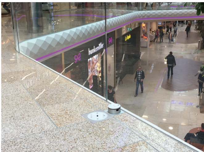
Bodensteckdose Fonto und Masso, Einkaufszentrum Plus City
